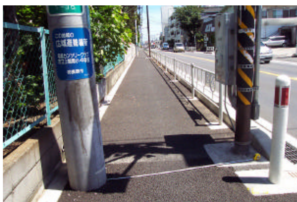
▲ 有効幅 1.45m～1.5×のネック箇所多数（歩道全幅 2.5m の有効性に甘え障害柱に対する観念たるみ）
